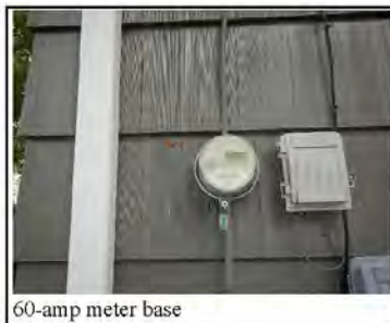
60-amp meter base
